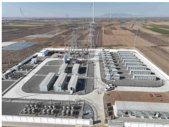
升压站 拍摄日期 2025.3.19
