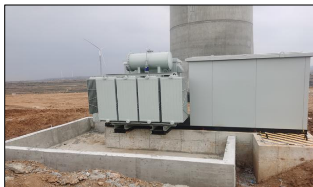
箱变及事故油池照片
