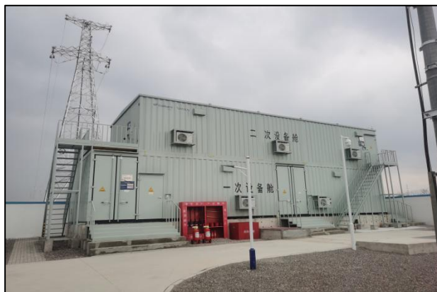
开关站内部照片
