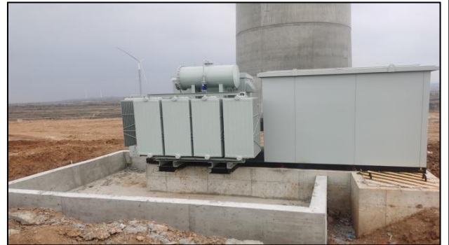
箱变及事故油池照片
