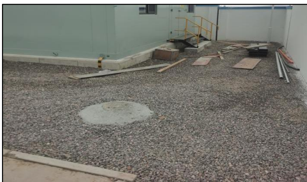
地埋式化粪池照片
