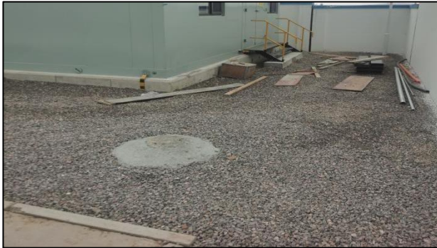
地埋式化粪池照片
